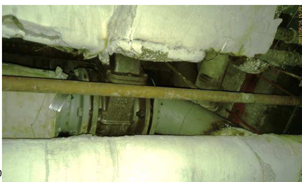
Vue d'une vanne en sous face du plafond technique des caves
